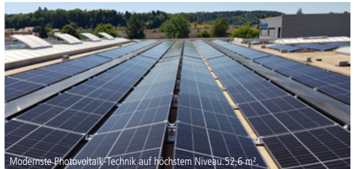
Modernste Photovoltaik-Technik auf höchstem Niveau. 52,6 m 2 .
